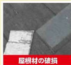
屋根材の破損
