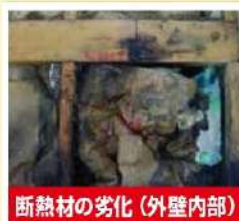
断熱材の劣化(外壁内部)
